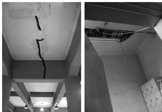
写真3・4 歩兵第十三聯隊食堂の亀裂等 ホール各所天井部に亀裂、小部屋天井の落下。熊本市中央区 大江。熊本学園大学第2体育館。
