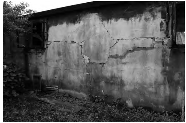
写真 18 隈庄飛行場油倉庫の被災状況 東側壁面の亀裂
