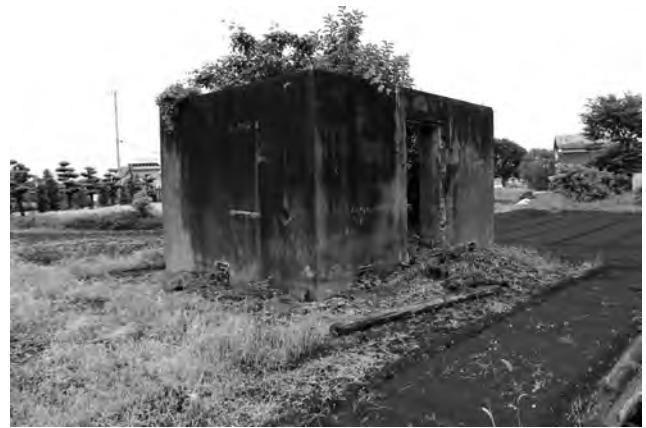
写真 16 隈庄飛行場弾薬庫の被災状況
