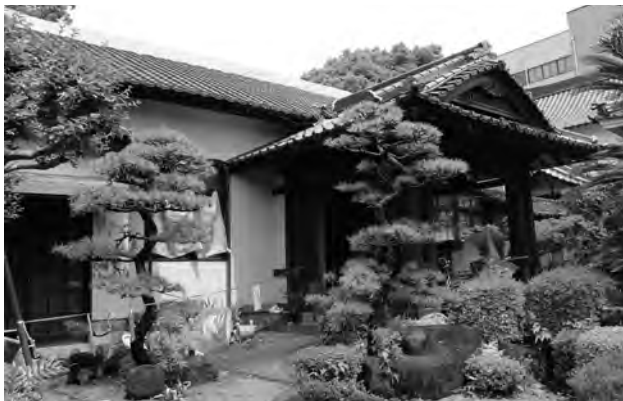
写真2 第六師団長官舎建物の破損 屋根瓦落下、壁剥離。熊本市東阿弥陀時町延寿寺寺務所。
