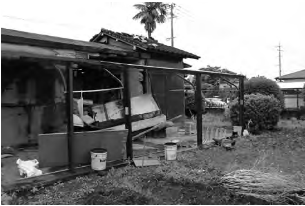
写真 17 隈庄飛行場油倉庫の被災状況 西側壁面の崩落
