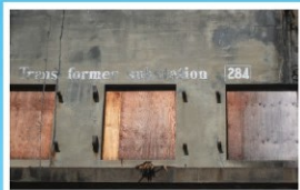
荒尾二造変電所接收番号
